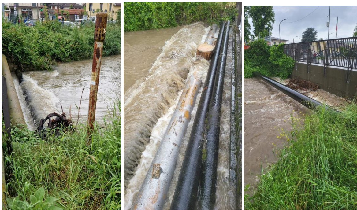
Figura 80 – Immagini dell'ostacolo al flusso costituito dagli attraversamenti dei sottoservizi idraulicamente inadeguati
