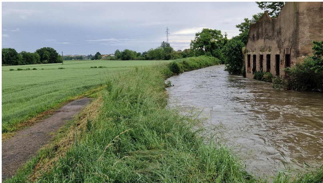
Figura 4 – Immagini della condizioni del fiume Olona durante il significativo evento meteorico del maggio 2024 (tratto a valle del ponte 3 - Ponte Largo Marinai D'Italia). Si evidenzia la condizione di corso d'acqua pensile per la maggior parte della sua sezione idraulica
